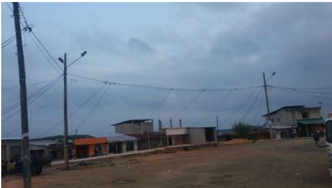
Anexo #5: Barrio de la parroquia urbana del cantón San Lorenzo, donde antes se generaban pérdidas para la CNEL San Lorenzo y ahora tienen cable preensamblado que permite mitigar las pérdidas mencionadas.
