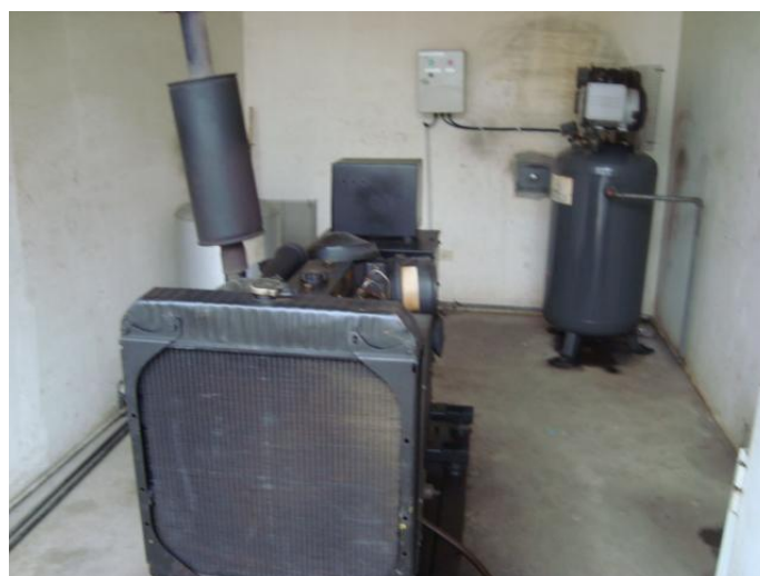
FIGURA 5 CUARTO DE MAQUINAS
