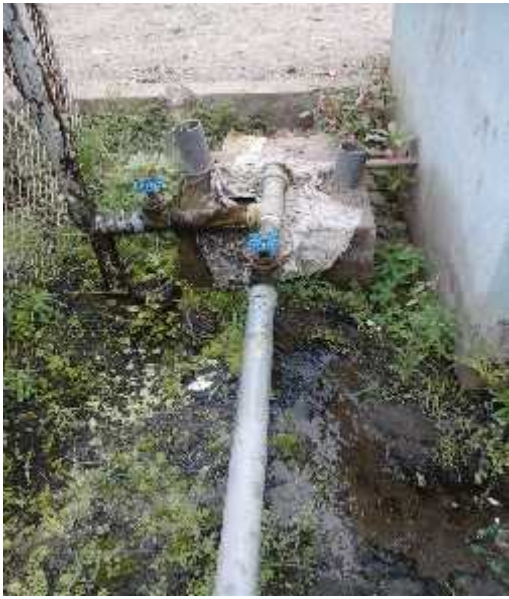
Estado de las llaves de los pozos
