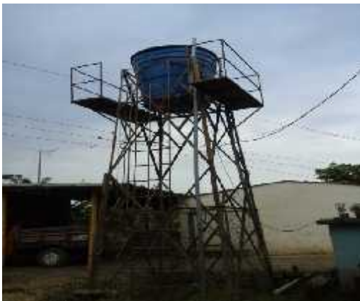
Tanque de pozo principal
